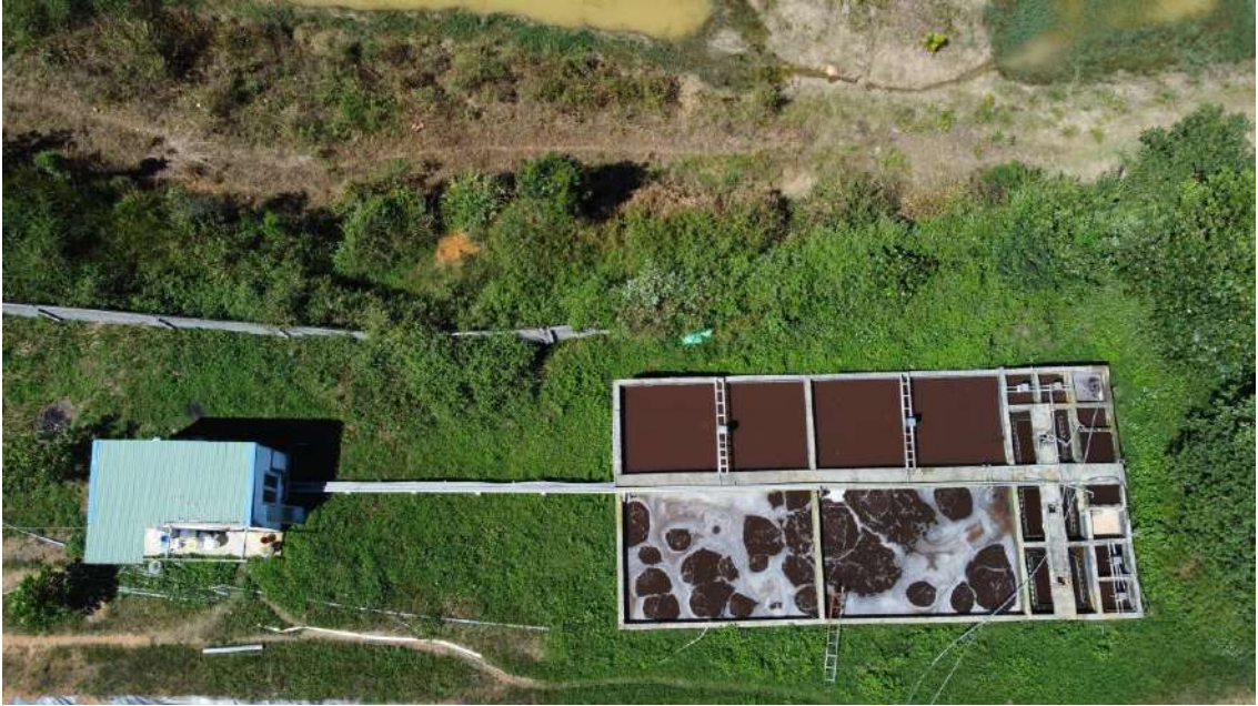
Hình 3.11: Hình ảnh cụm hệ thống xử lý nước thải
