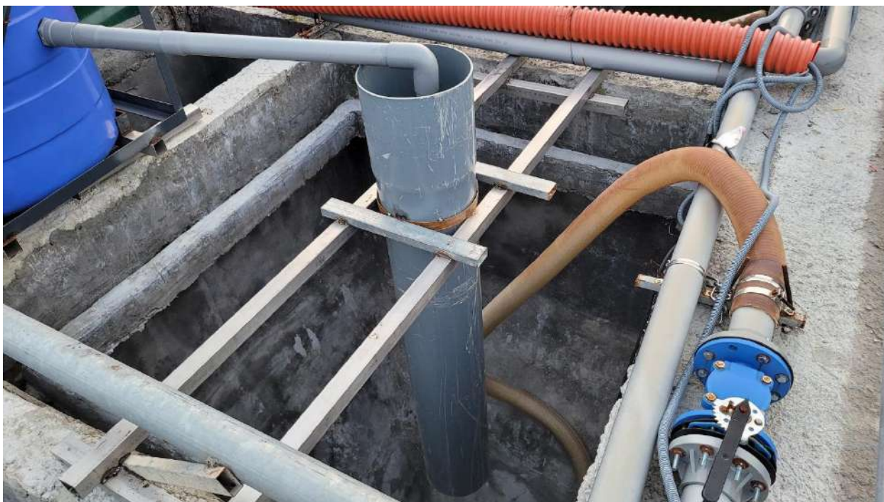
Hình 3.9. Bể lắng sinh học
