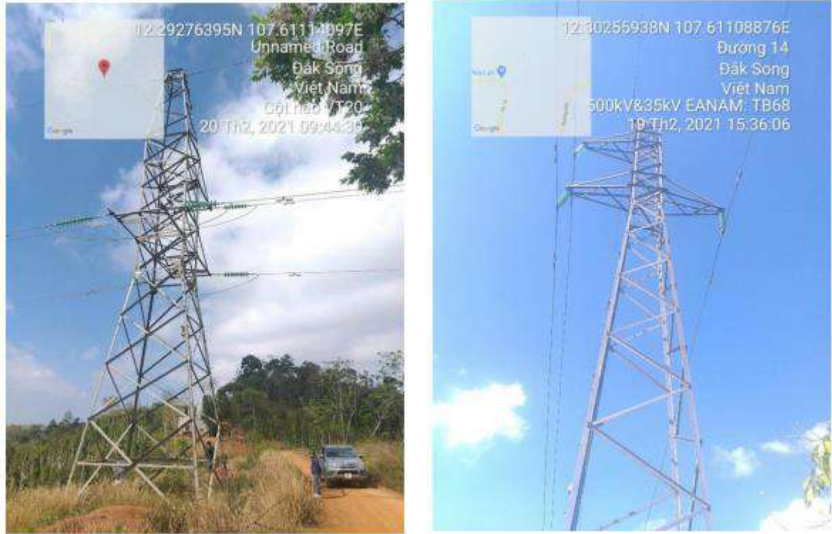
Hình 1. 11: Trụ néo 20 và trụ đỡ 21 của tuyến đường dây hiện hữu
