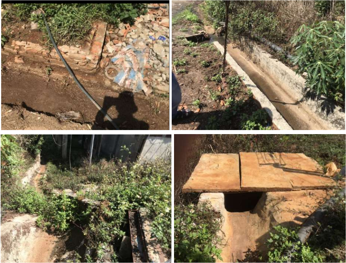
Hình 5. Hệ thống mương thoát nước mưa chung của nhà máy và hố ga trước khi chảy ra suối
