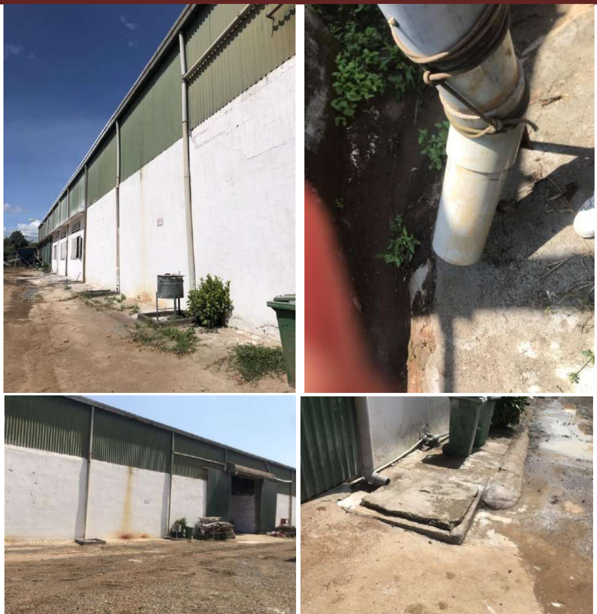
Hình 4. Hệ thống thoát nước mưa trên mái nhà xưởng
