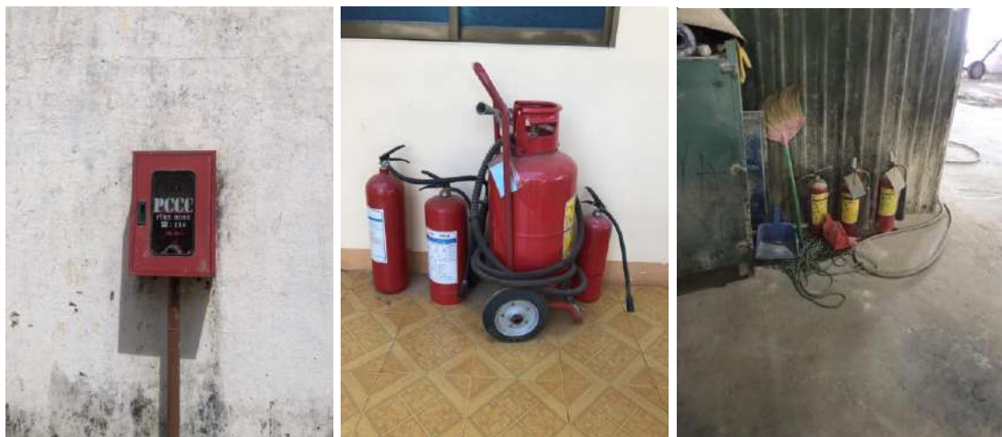
Hình 22. Bình CO 2 và trụ bơm cứu hỏa
