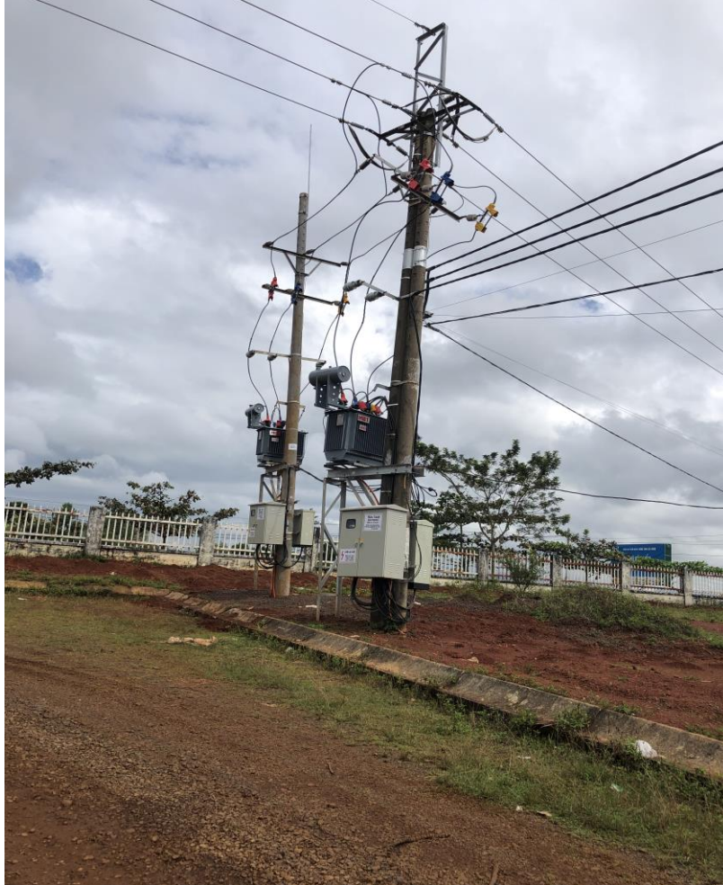
Hình 1.2. Trạm điện hạ thế đã được lắp đặt trong Cụm công nghiệp
