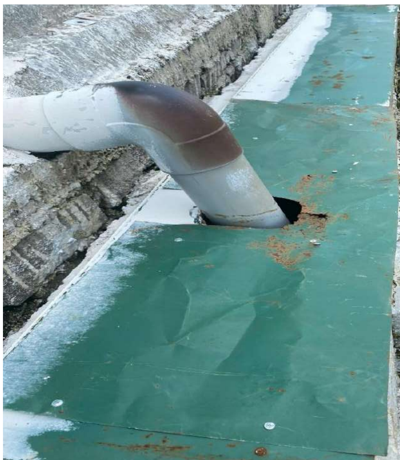
Hình 3.5: Hệ thống mương kín, thu gom nước thải dọc hai bên dãy chuồng nhà nuôi heo số 01
