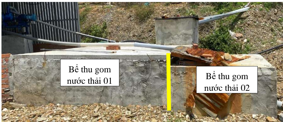
Hình 3.8: Bể thu gom nước thải 01 và bể thu gom nước thải 02
