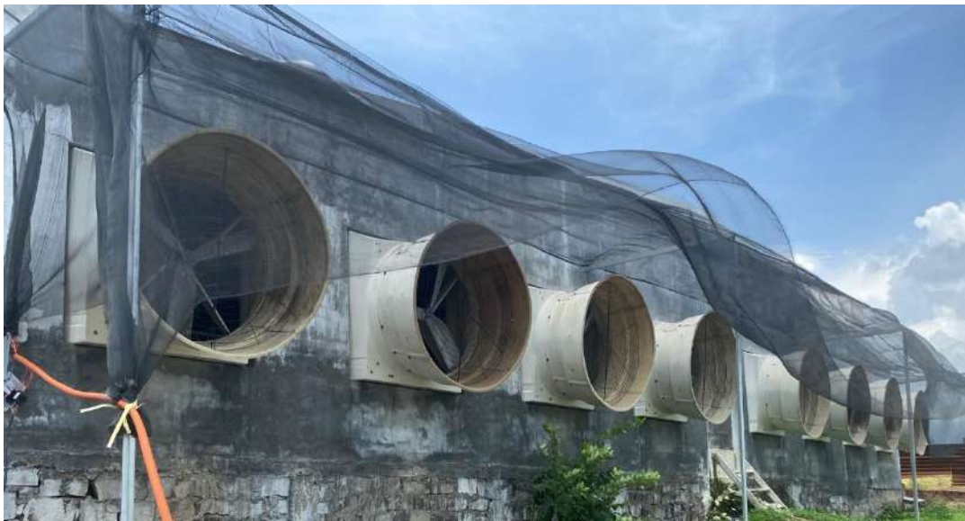
Hình 3.17: Hình ảnh khung lưới che chắn kết hợp hệ thống phun khử mùi sau quạt hút
