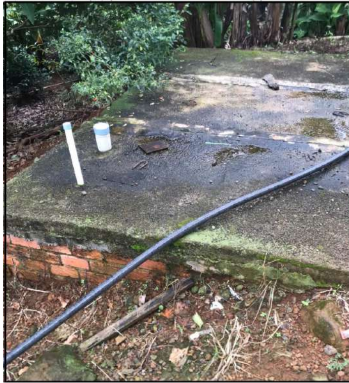
Hình 19. Bể tự hoại 3 ngăn tại cơ sở
