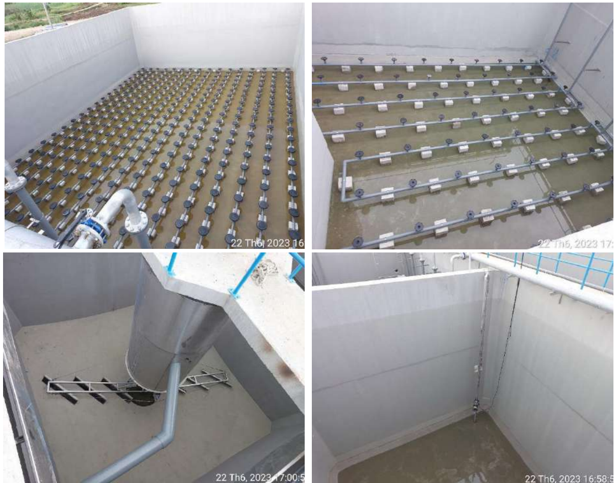
Hệ thống xử lý nước thải 200 m 3 /ngày
