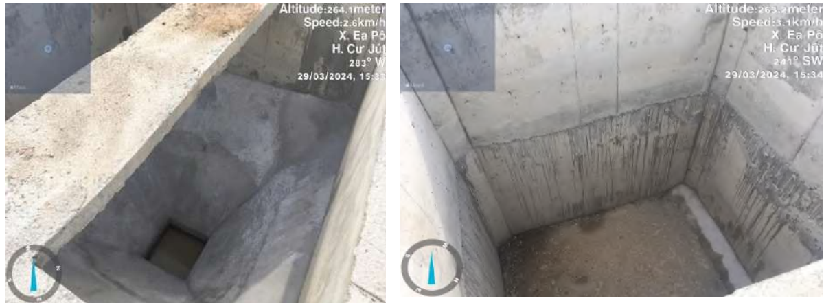
Hệ thống xử lý nước thải 200 m 3 /ngày
