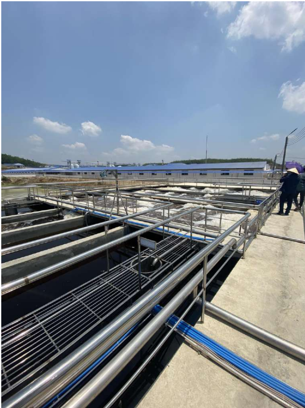
Hình 3.11: Hình ảnh cụm xử lý nước thải
