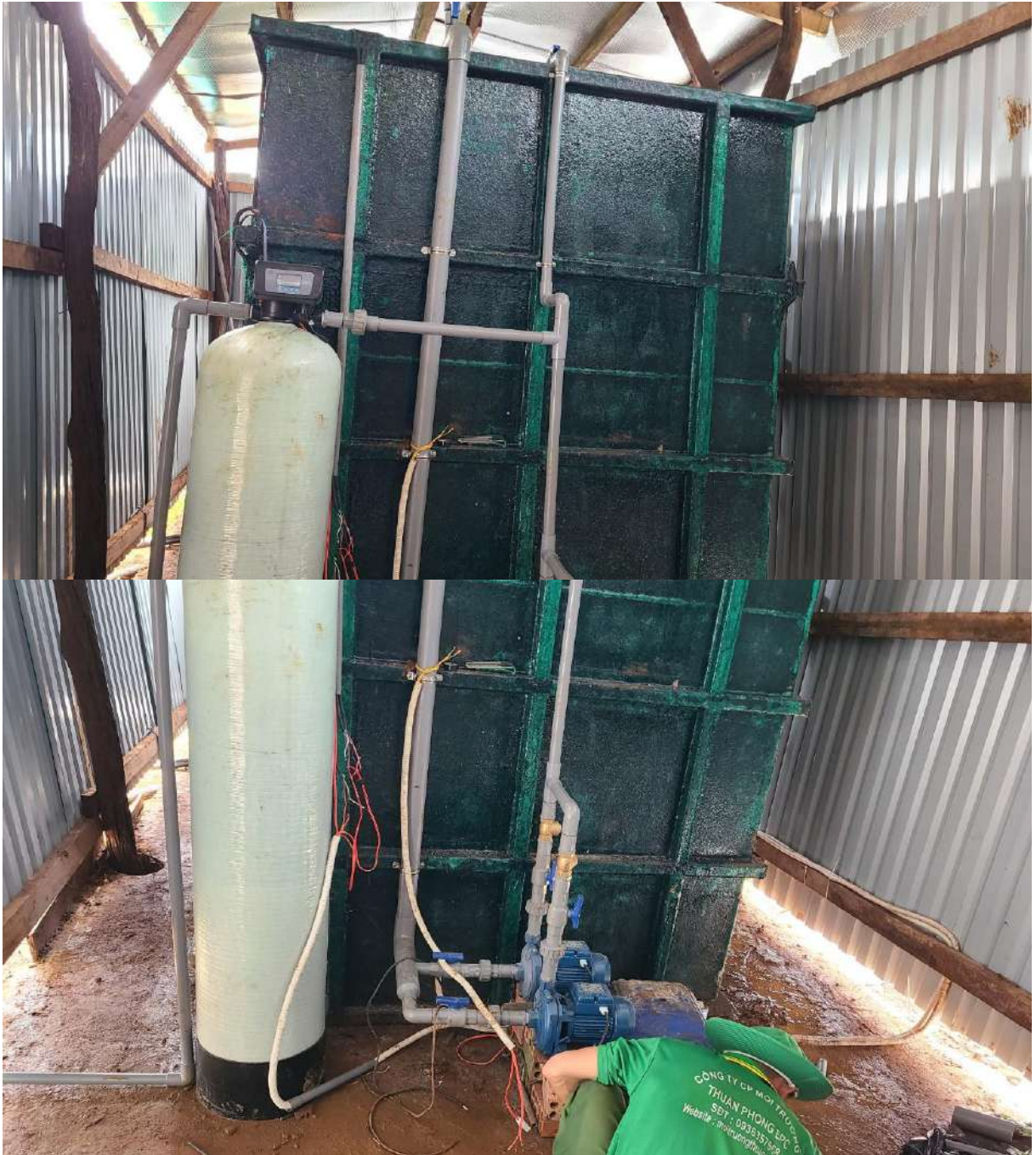
Hình 4.15. Hình ảnh Modul xử lý nước thải – công suất 50m 3 /ngày đêm của Trang trại chăn nuôi Hộ gia đình Phan Văn Quý tại xã Đắc Ru, huyện Đắc R’Lấp
