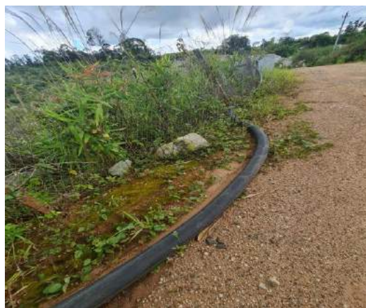
Hình 8: Đường ống bơm thoát nước từ moong ra hố lắng ngang
