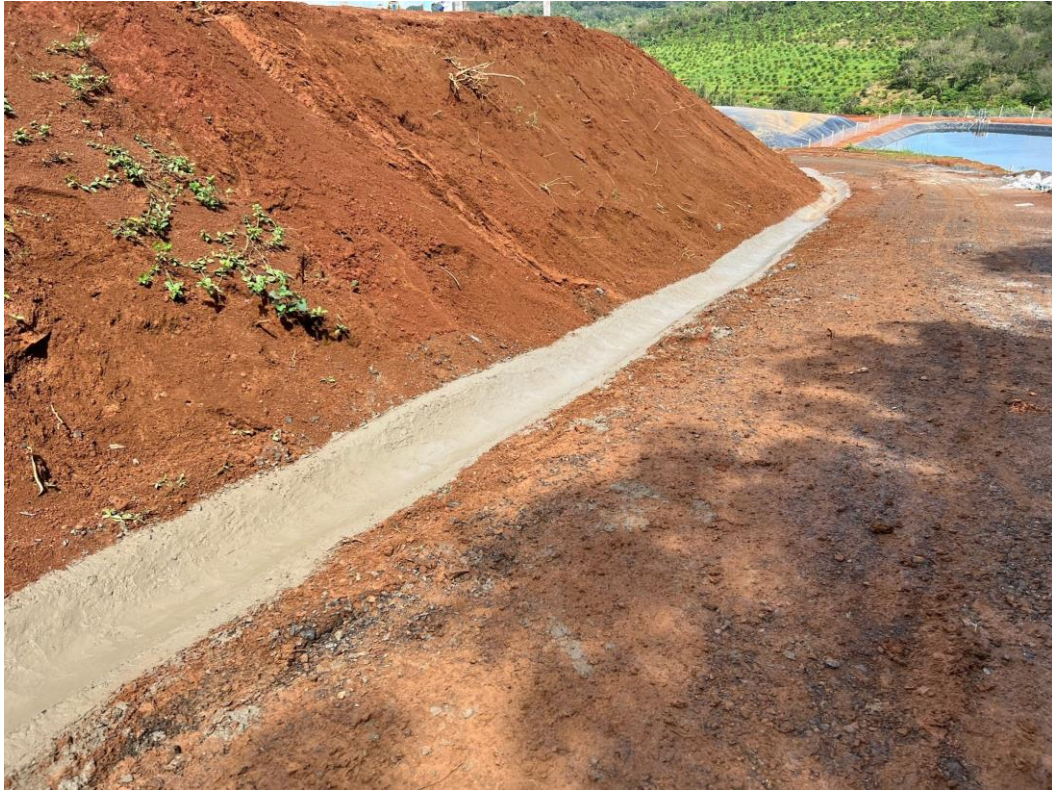
Hình 3.3. Mương thoát nước mưa của dự án
