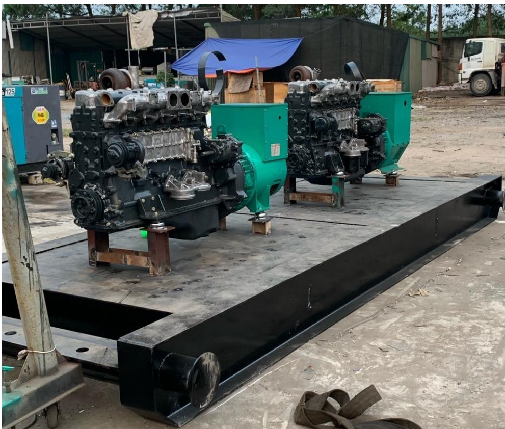
Hình 3.10. Hình ảnh máy phát điện Biogas
