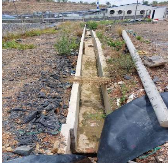
Hình 3.2: Tuyến thu gom nước mưa
