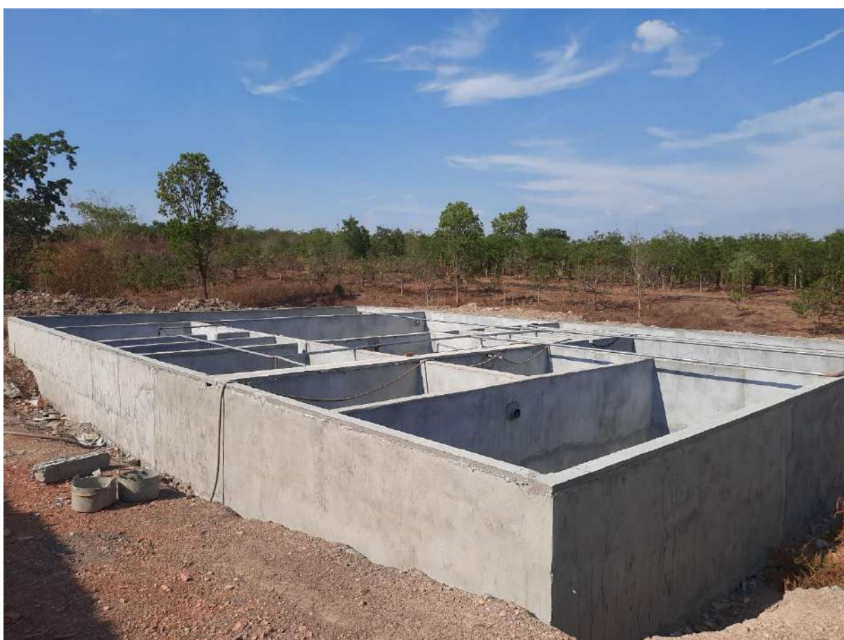
Hình 1.8. Cụm xử lý thuộc hệ thống xử lý nước thải
