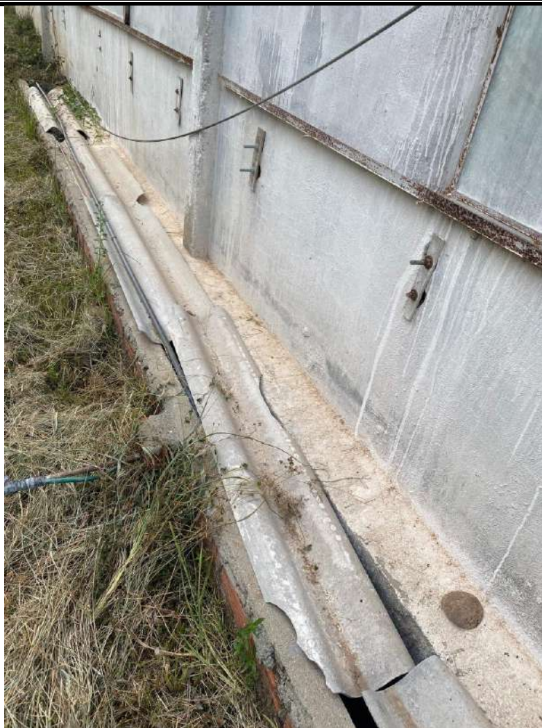
Hình 1.12: Mương gạch thu gom nước thải
