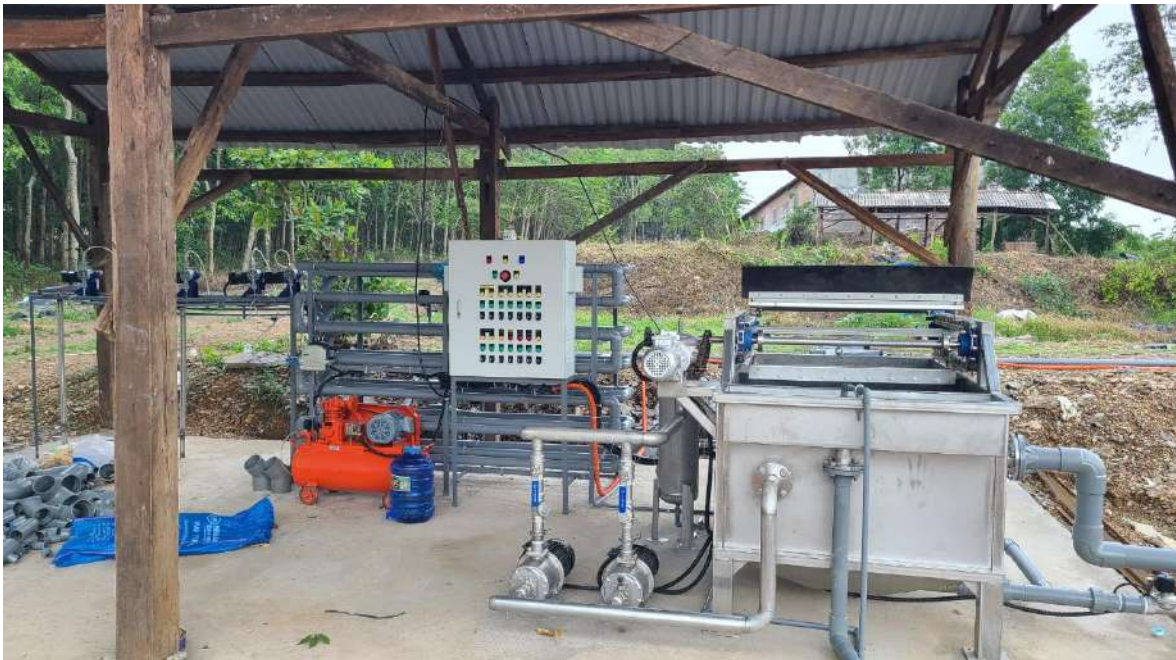
Hình 3.8: Cụm XL hóa lý lắp đặt tại trang trại
