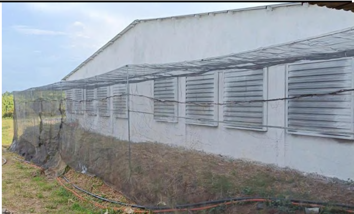
Hình 3.18: Hình ảnh khung lưới che kết hợp hệ thống phun khử mùi sau quạt hút
